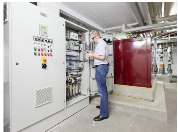
Energiezentrale eines Essener Altenheims
