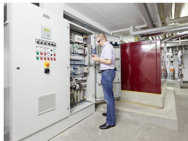
Energiezentrale eines Essener Altenheims
