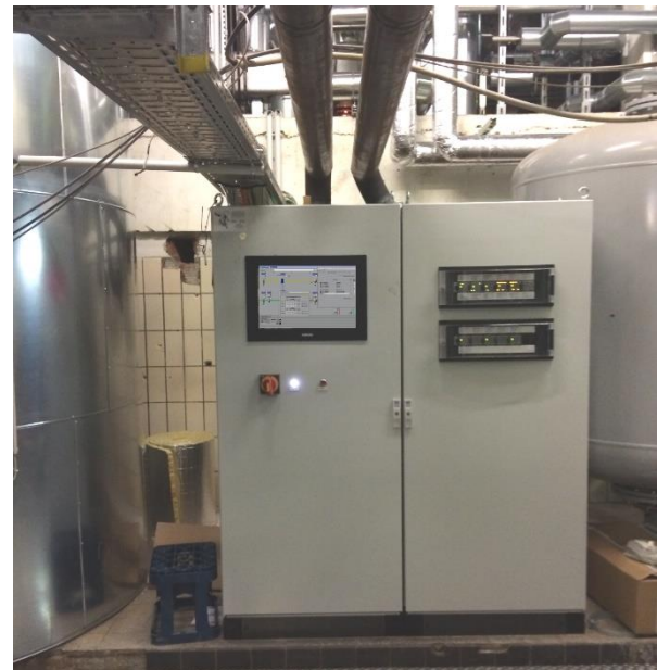
Abb.: Steuereinheit einer Klimaanlage
