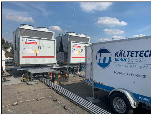
Abb.: Steuereinheit eines Kaltwassererzeugers
